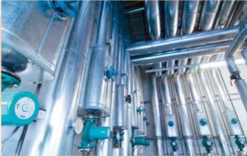
In der Kältetechnik liegt ein großes Potenzial zur Senkung der Energiekosten.
