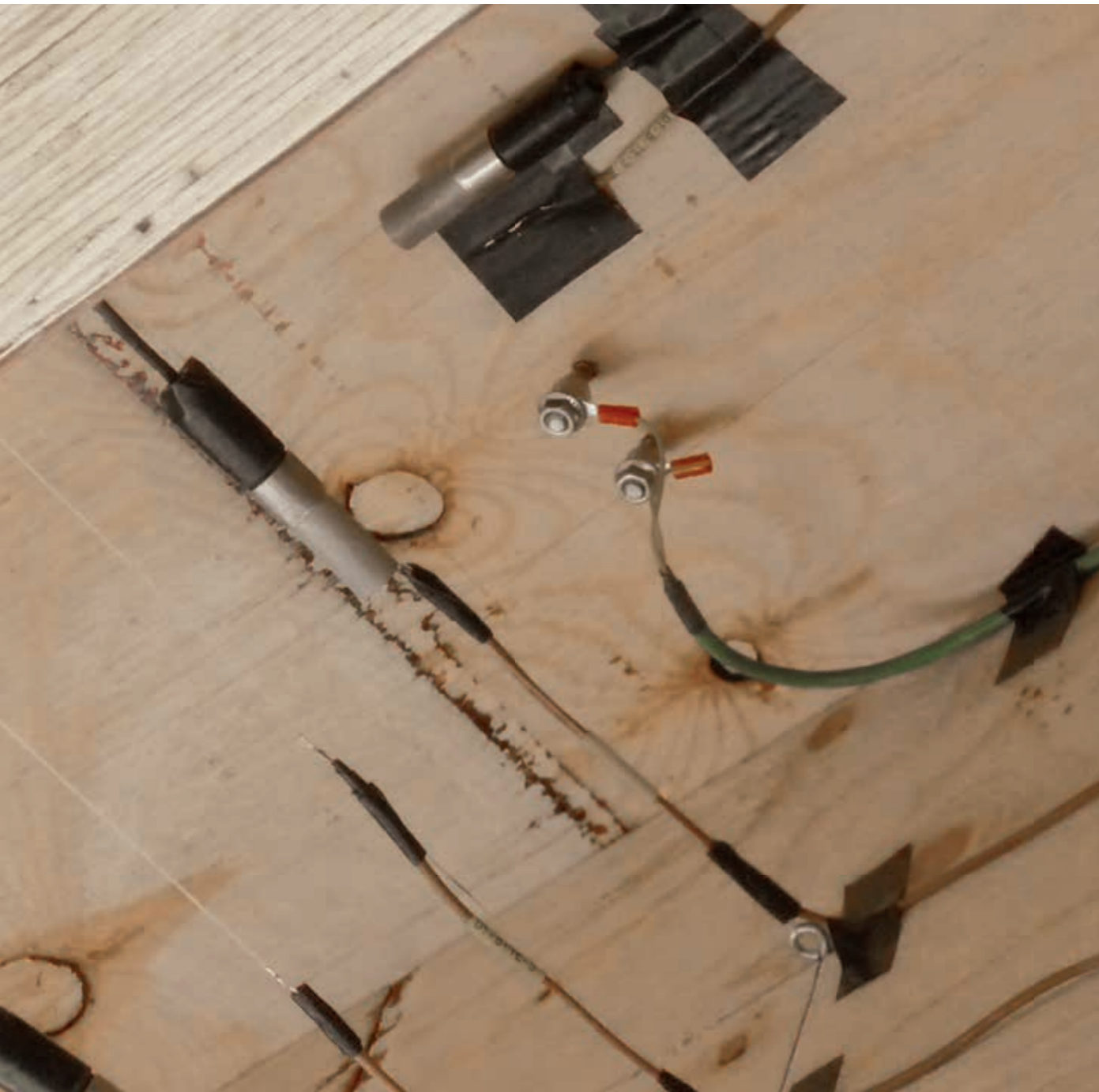
† Sensoren zur Messung der Holzfeuchte des Konstruktionsholzes sowie der Temperatur und relativen Feuchte im Dämmstoff in der Decke des Schulungsraums
